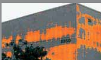
L'immagine FLIR Thermal Fusion rileva delle differenze di temperatura, mostrando i danni provocati dall'acqua ed anomalie strutturali dell'edificio.
